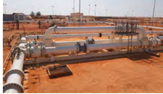
Tam dolu olmayan borulardaki atık suyun akış ölçümü
