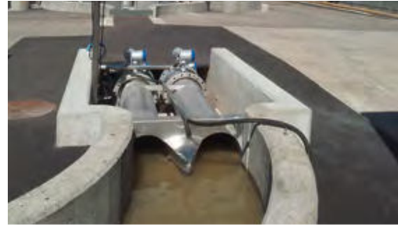
Kısmen dolu borulardaki atıksuyun akış ölçümü
