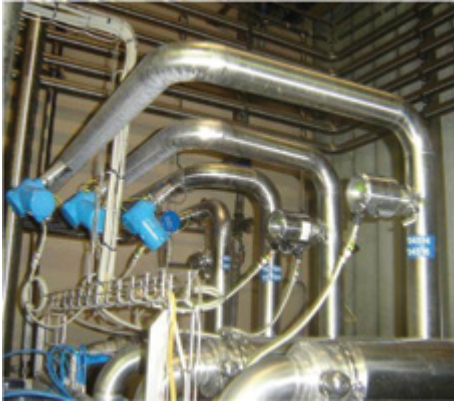
Contrôle de débit sur station NEP
