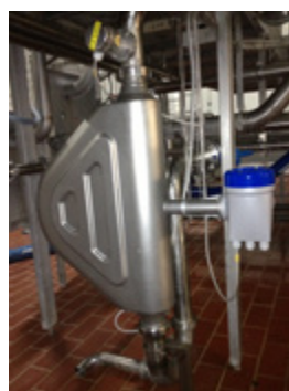
Installation d'un OPTIMASS 6400
