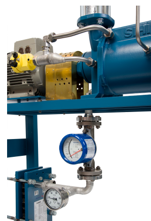
Le H250 M40 surveille l'alimentation en fluide de fonctionnement
