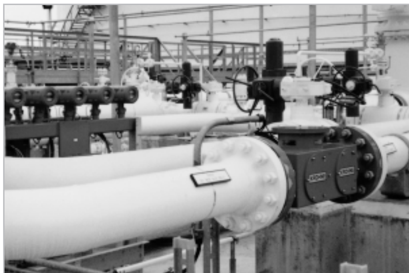
Abb. 29: Geeichter Ultraschall- Volumenzähler ALTOSONIC V mit 5 Messpfaden in einer Pumpstation der RRB
